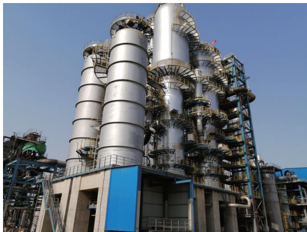
图 3 濮阳市远东科技有限公司 15 万吨/年丙烷脱氢制丙烯工业示范装置(即将建成投产)
